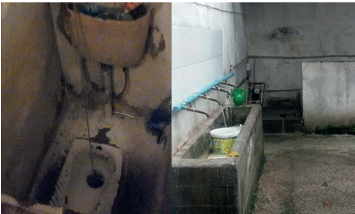
Убактылуу кармоочу изоляторлордо абал оор бойдон
